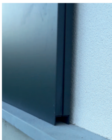
Particolare parte inferiore anta
